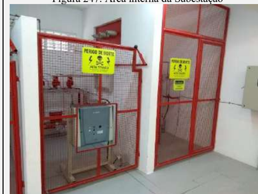
Figura 247. Área interna da Subestação
