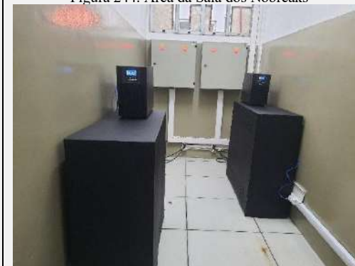
Figura 244. Área da Sala dos Nobreaks
