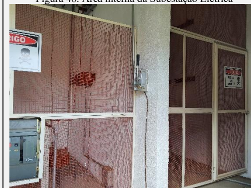
Figura 48. Área interna da Subestação Elétrica
