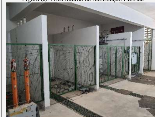
Figura 66. Área interna da Subestação Elétrica
