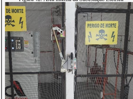
Figura 42. Área interna da Subestação Elétrica
