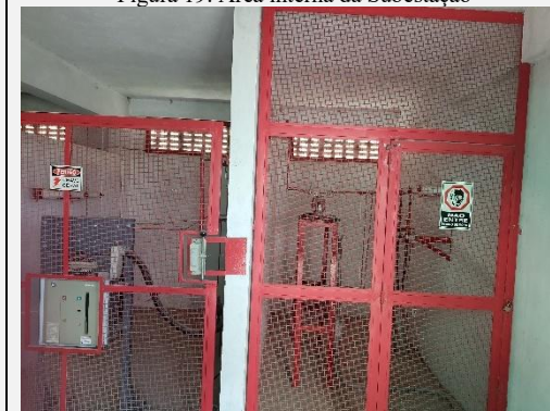
Figura 19. Área interna da Subestação
