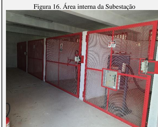
Figura 16. Área interna da Subestação
