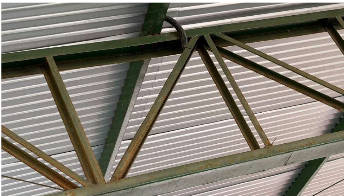
Fotografia 68 oxidação estrutura da quadra
