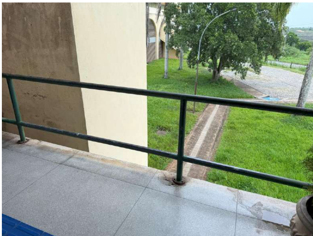
Fotografia 21 - Guarda corpo irregular
