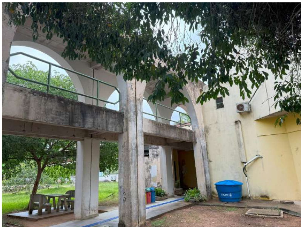
Fotografia 102 - Guarda corpo irregular
