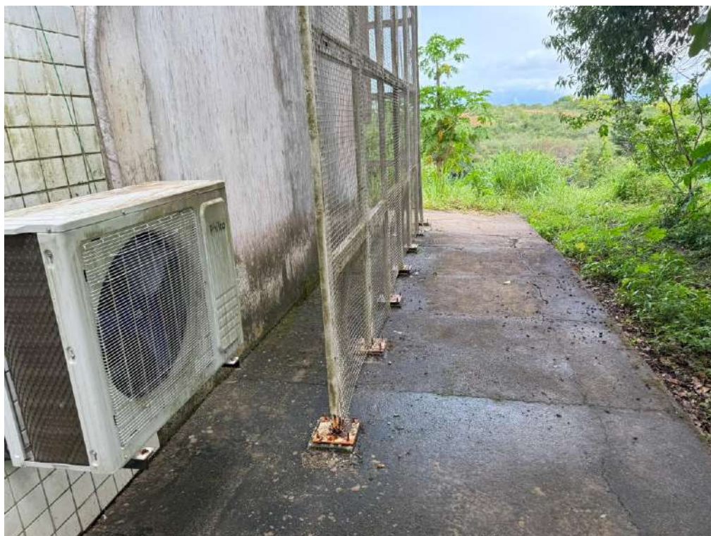
Fotografia 116 - Estrutura metálica deteriorada
