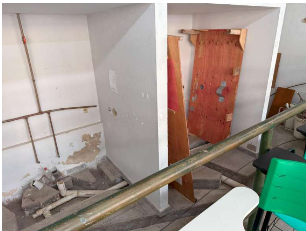
Fotografia 91 - Necessidade de reparos
