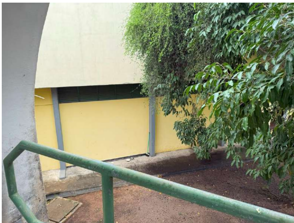
Fotografia 52 - Guarda corpo irregular
