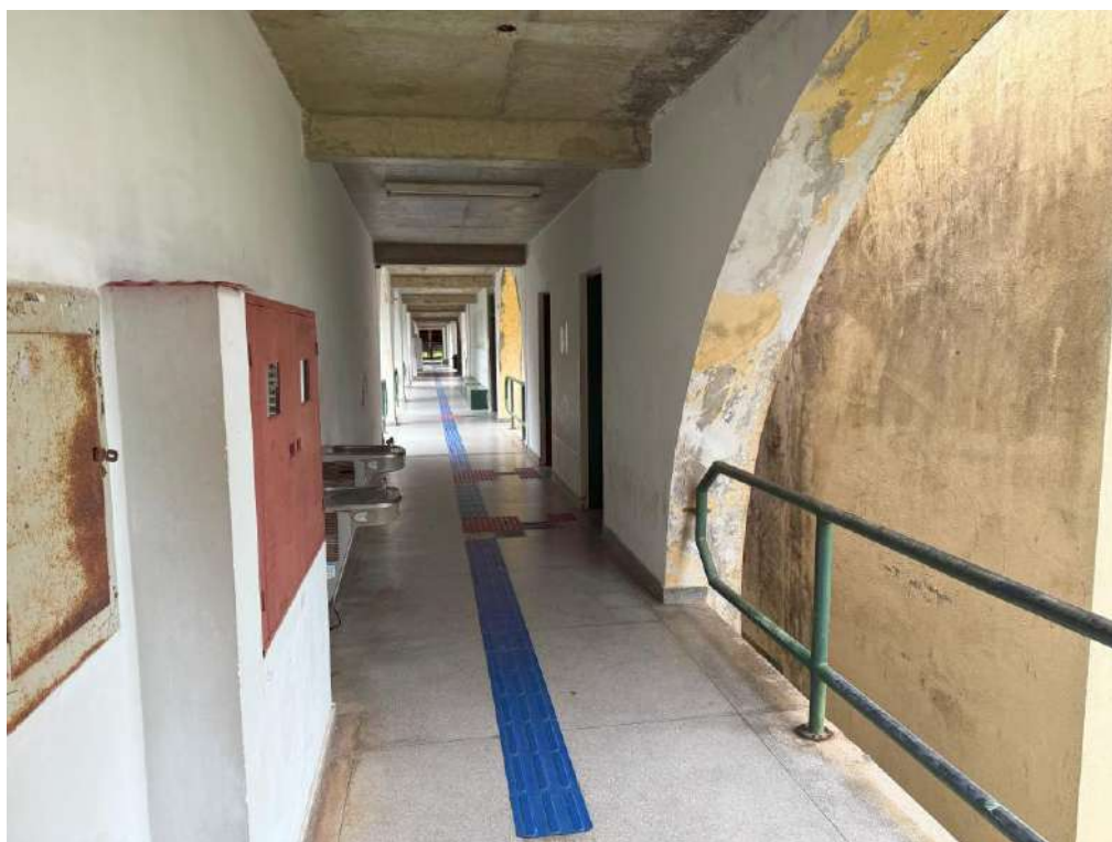
Fotografia 22 - Guarda corpo irregular
