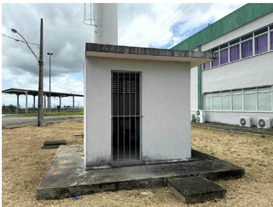
Fotografia 32 casa de bomba
