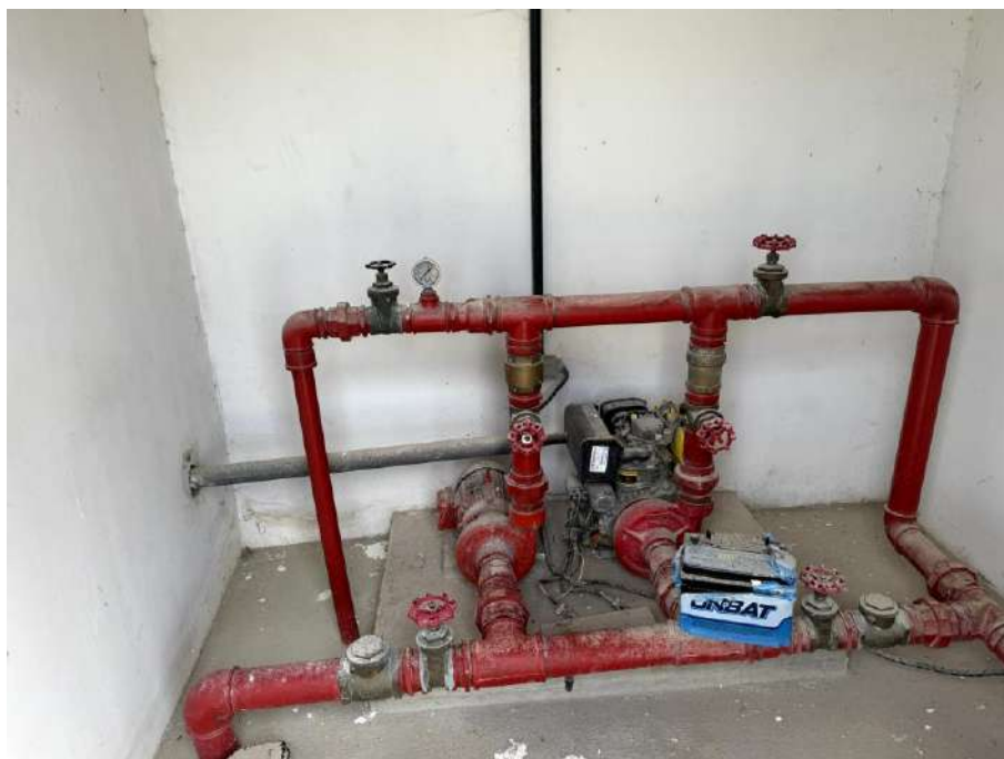
Fotografia 33 casa de bombas
