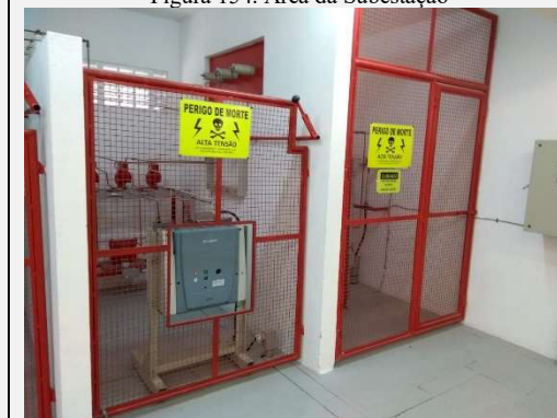
Figura 154. Área da Subestação
