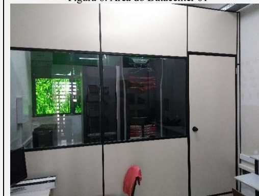
Figura 6. Área do Datacenter 01
