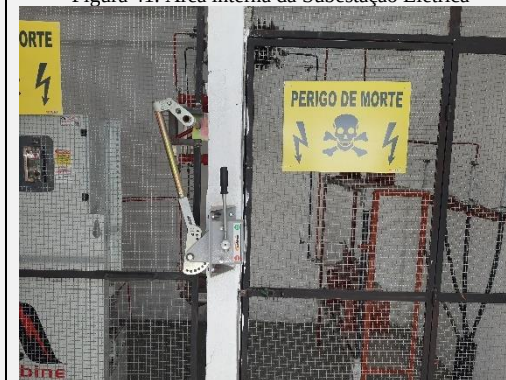
Figura 41. Área interna da Subestação Elétrica
