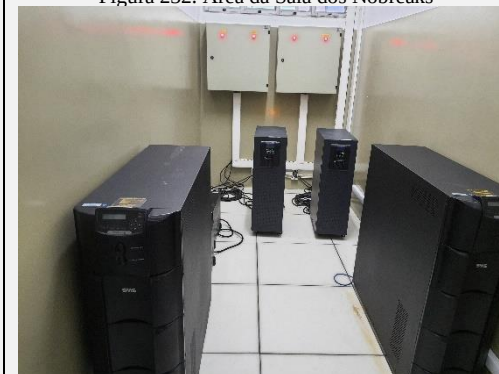
Figura 232. Área da Sala dos Nobreaks
