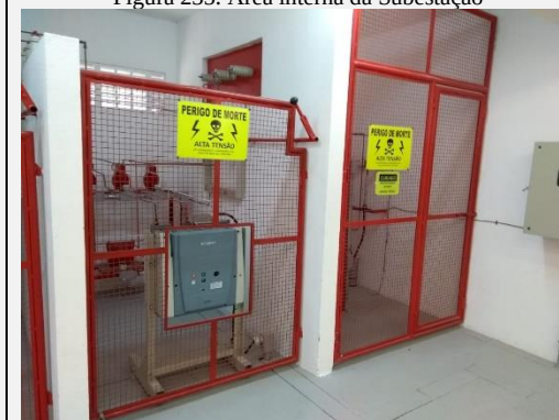
Figura 235. Área interna da Subestação
