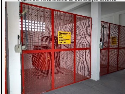
Figura 56. Área interna da Subestação Elétrica
