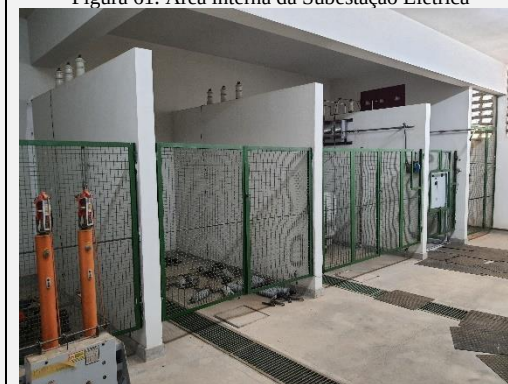
Figura 61. Área interna da Subestação Elétrica
