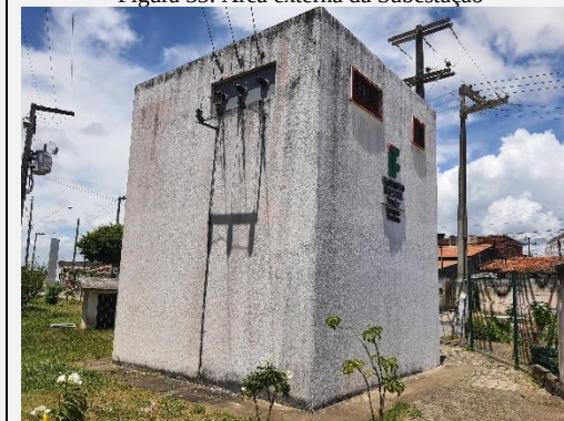
Figura 35. Área externa da Subestação
